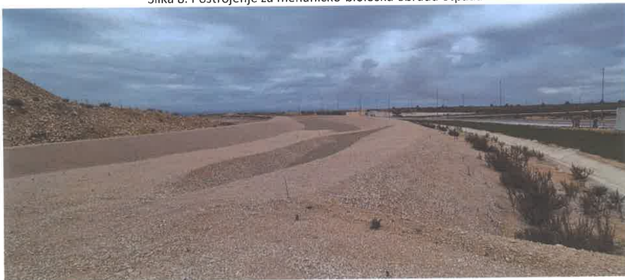
Slika 9. Ploha za odlaganje azbestnog otpada
