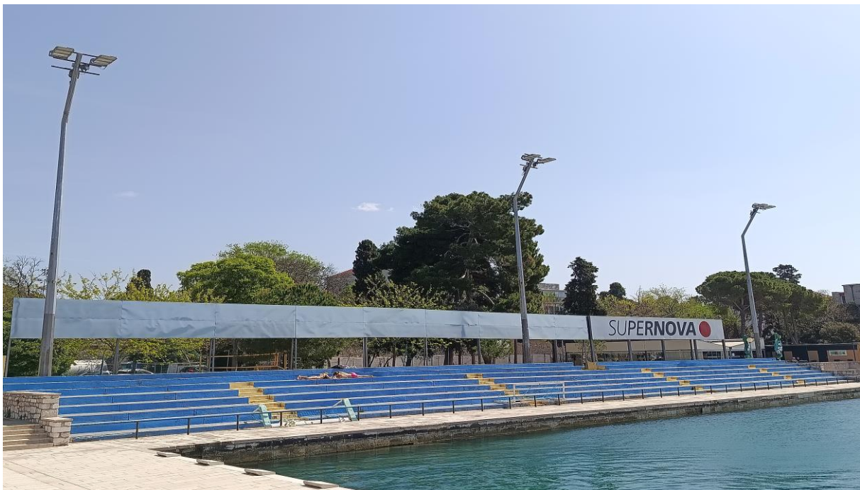
Slika broj 30: Ugrađeni LED reflektori na Otvorenom plivalištu
