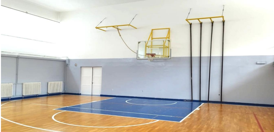
Slika br. 10 Bojani zidovi i plafon dvorane
