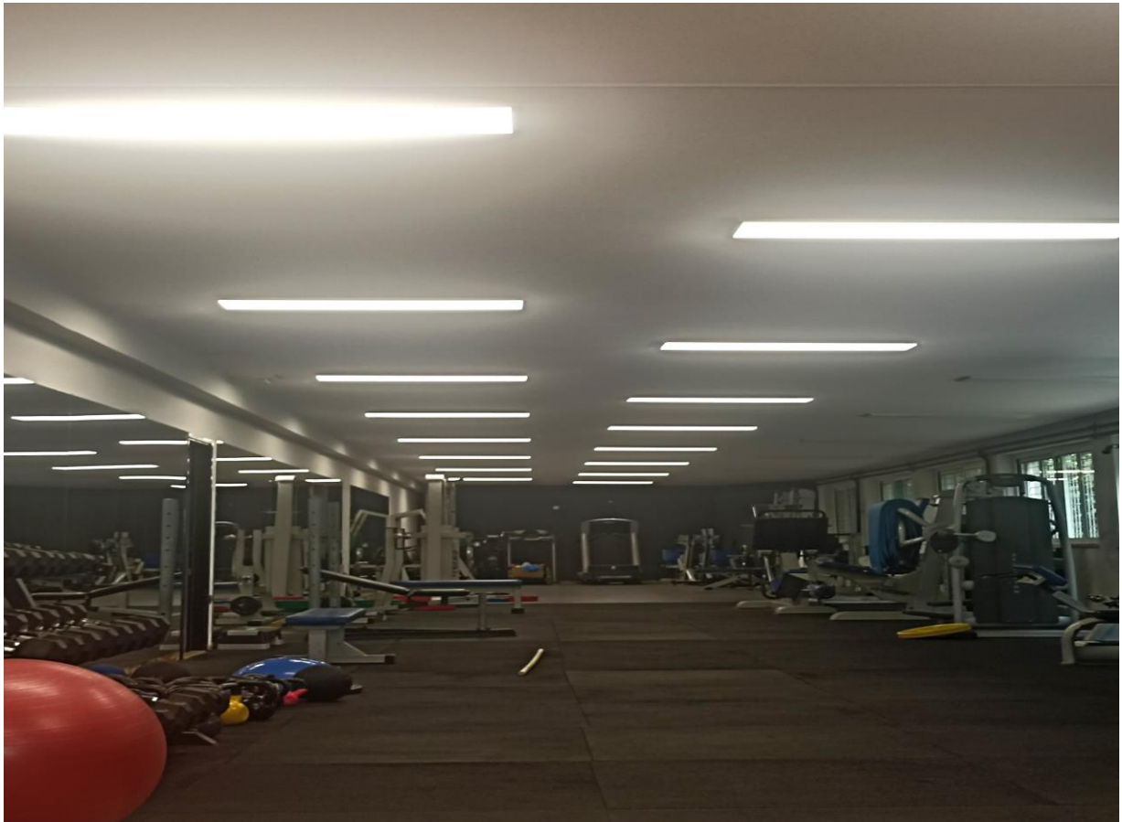
Slika br.11 Nova rasvjeta u dijelu sportskog objekta u skopu ŠRC Ravnice
