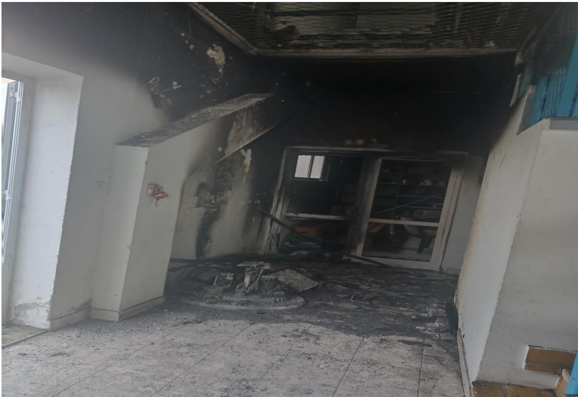
Slika br. 22 Dvorana Mocire nakon požara
