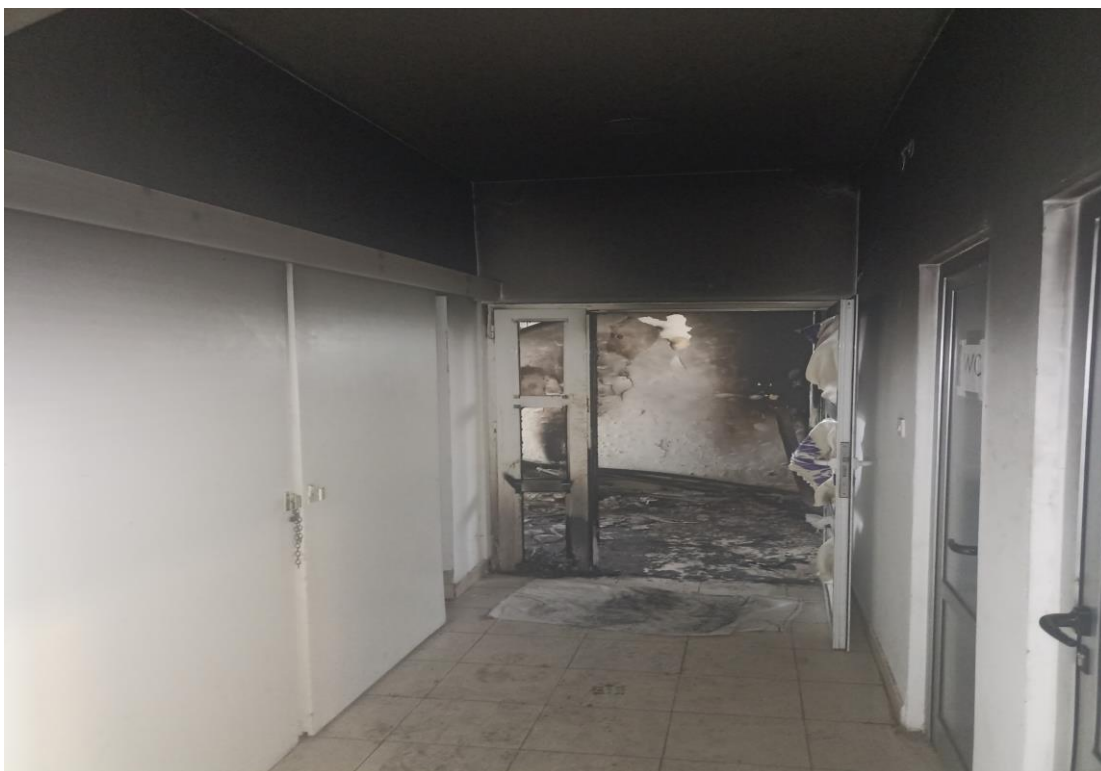
Slika br. 24 Dvorana Mocire nakon požara
