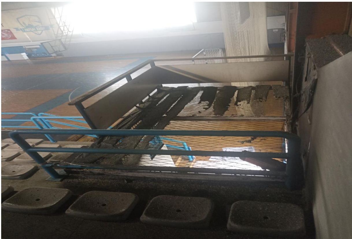
Slika br. 25 Dvorana Mocire nakon požara
