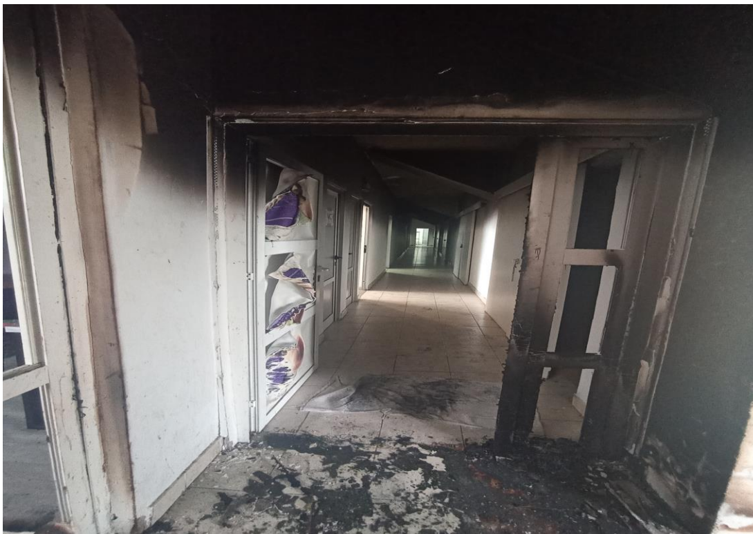
Slika br. 23 Dvorana Mocire nakon požara
