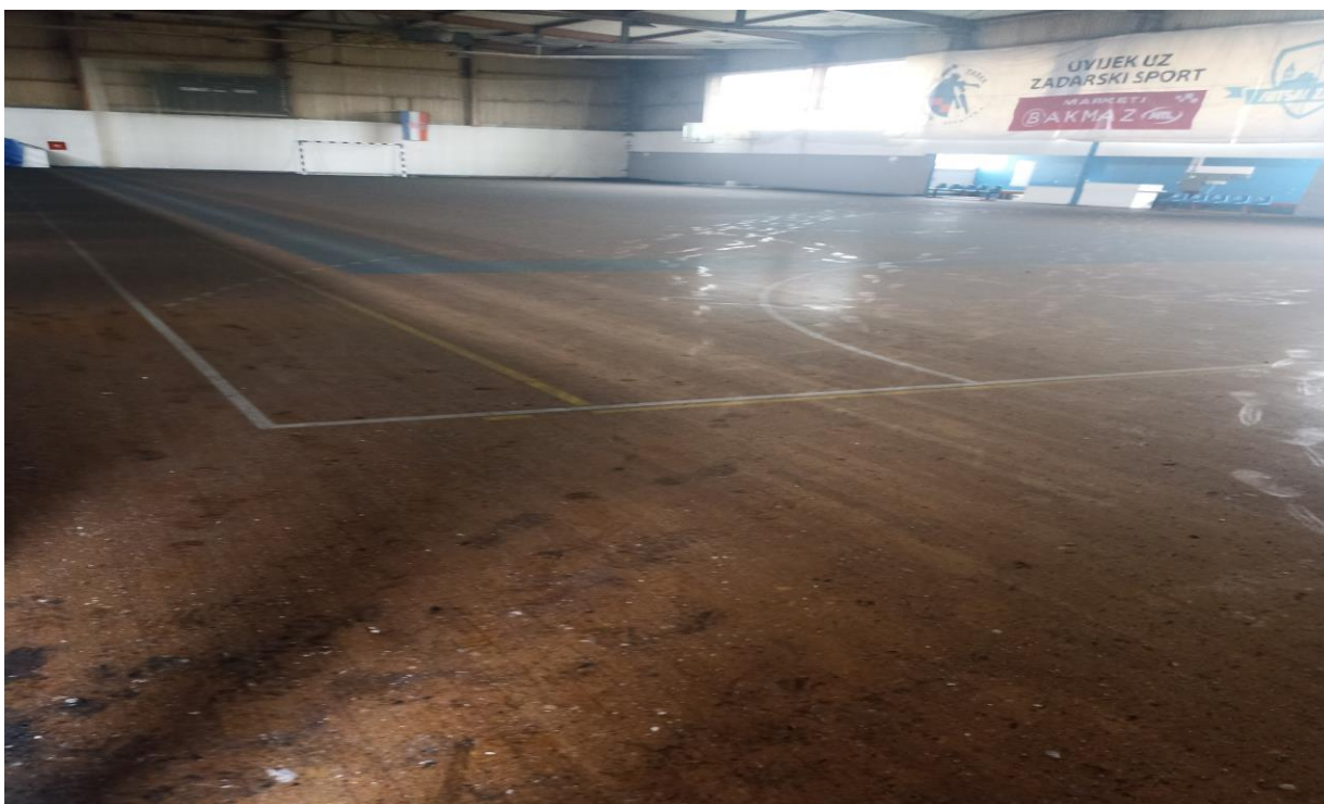
Slika br. 26 Dvorana Mocire nakon požara
