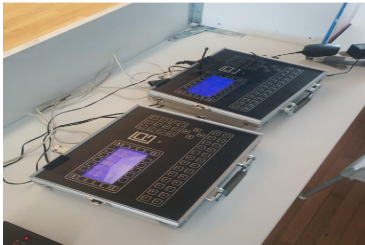
Slika br.19 Upravljačka konzola električnog semafora
