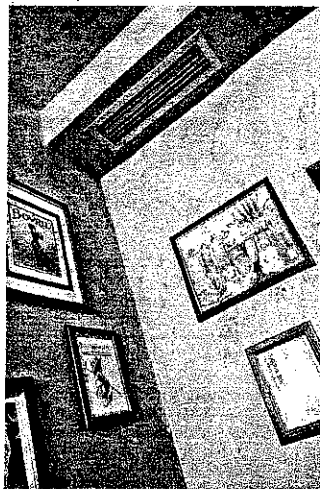
Ugradnja ventilacije "leška" je oko pet tisuća eura
