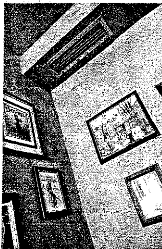
Ugradnja ventilacije "leška" je oko pet tisuća eura
